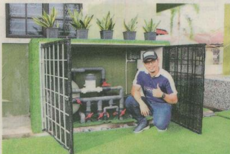
Rasyad menunjukkan sistem digunakan TB Pool yang dipercayai mampu menjimatkan bil elektrik dan air di kolam renang dibina.
